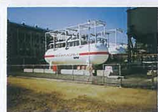
アンモニアタンク
