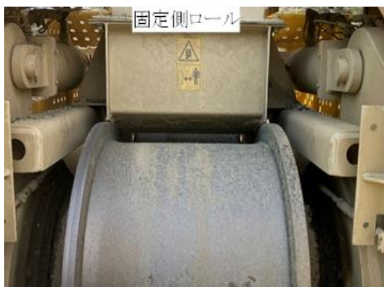
写真4. 固定側ロール摩耗状況（1800 時間経過後）
